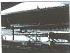
Canalisation pour analyse chimique des gaz.
